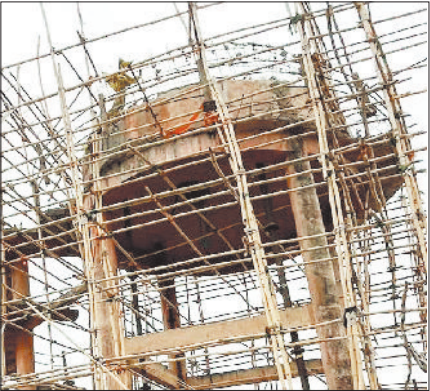
जर्जर पानी टंकी पर लगाया गया बांस का ढांचा।
